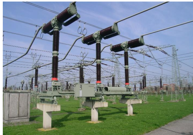
Circuit breaker 3AS2 245kV
